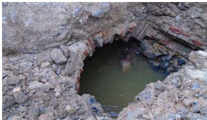
Vista da parte do caneiro que abateu
