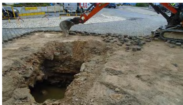
Vista do local onde o caneiro colapsou.
