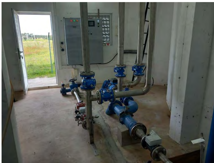
Aspeto da camara de manobras do R. Vale da Pedra.
